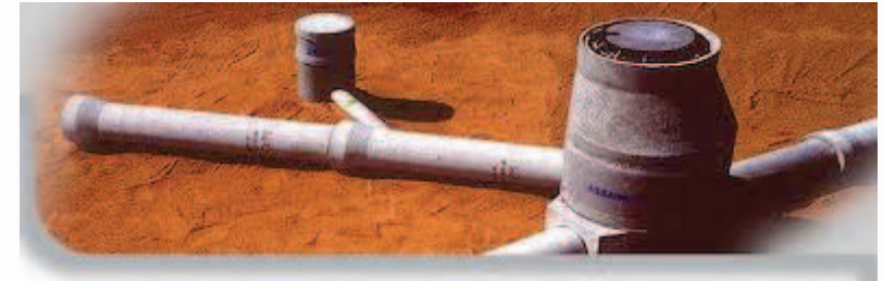
Réseau assainissement (regards et réseau)
